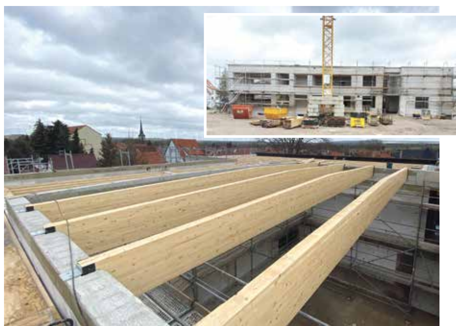
Am Baukörper der Grundschule Goldbach wurde jetzt der Dachstuhl fertiggestellt. Die Baustelle liegt im Zeitplan, im Herbst 2022 sollen hier wieder die Kinder lernen.
