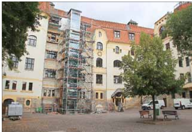
Ab Herbst ermöglicht der Aufzug einen barrierefreien Zugang zu allen Etagen der Arnoldschule. Hier wird künftig auch der Kreistag zusammen kommen.
